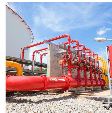
HỆ THỐNG PCCC FIRE ALARM SYSTEM
